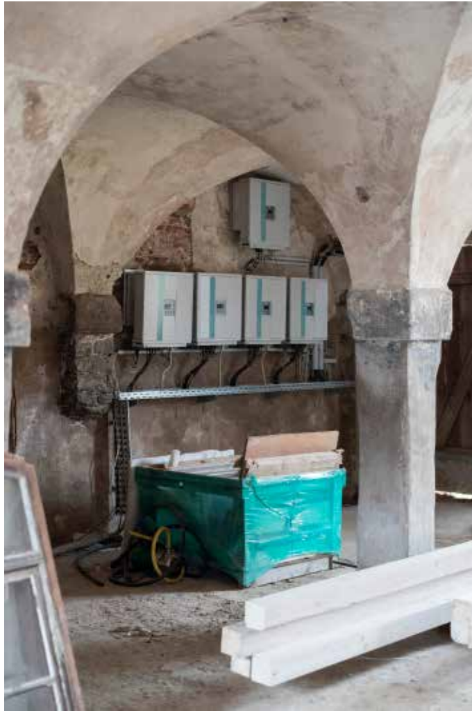
Im ehemaligen Stall sirren die Wechselrichter. Sie wandeln den Gleichstrom in Wechselstrom um, damit er direkt ins Netz eingespeist werden kann. „An sonnigen Tagen ist es hier drinnen viel lauter.“
